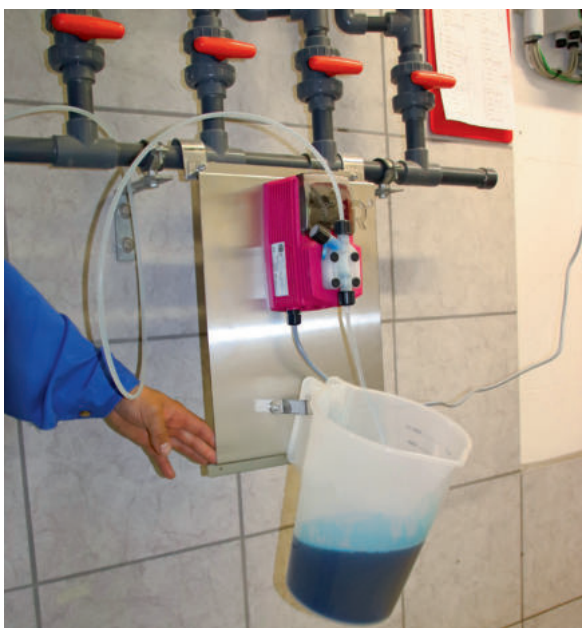
Die Ileitispumpe ist an der Wasserleitung installiert und pumpt die Impfstofflösung zu den Abteilen.
